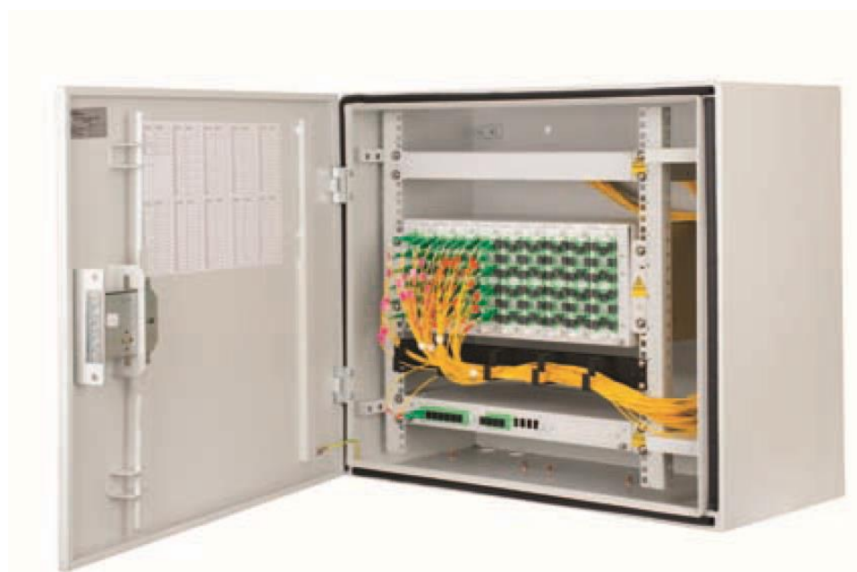
Рисунок 4.8 – Размещение оборудования в антивандальном шкафу
