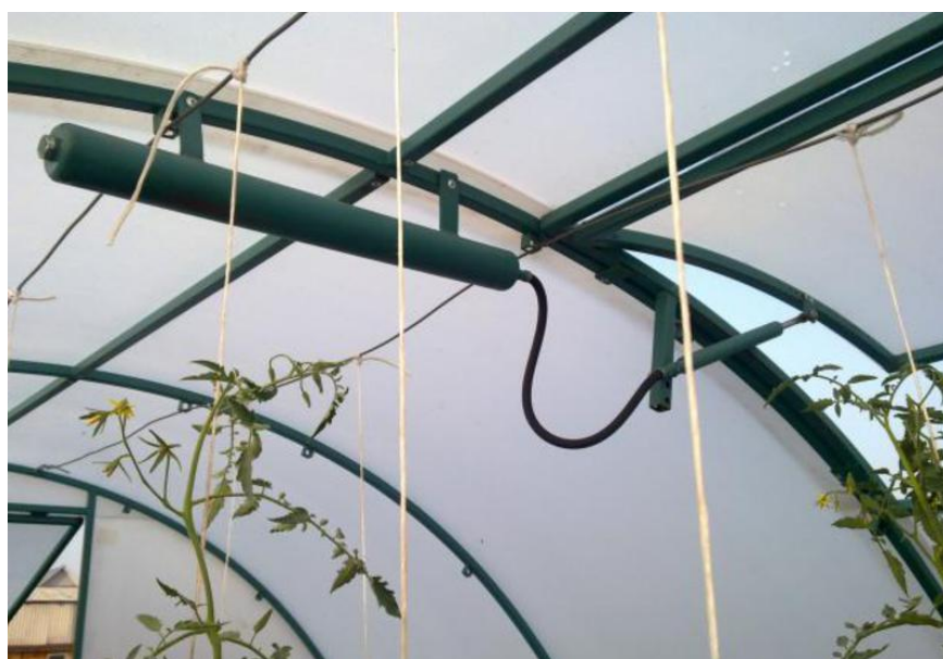
Рисунок 4 – Система вентиляции теплицы с гидравлическим цилиндром
