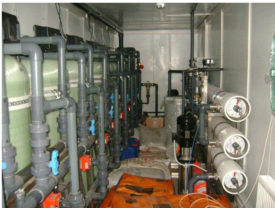
Рисунок 5.1 – Установка химводоподготовки «Сокол»
