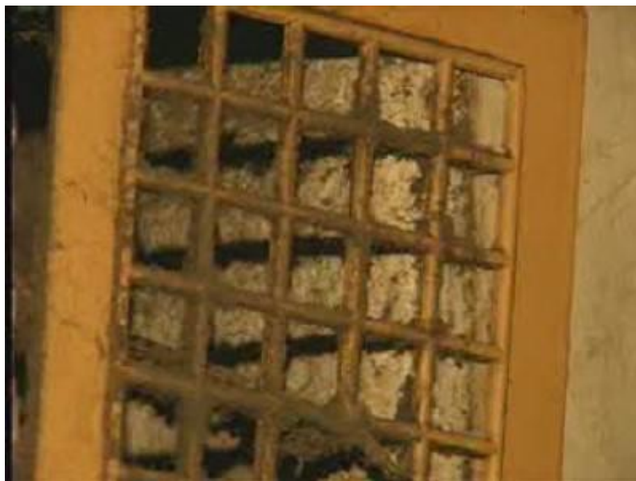
Рисунок 1.19 Вытяжное отверстие, требующее срочной прочистки
