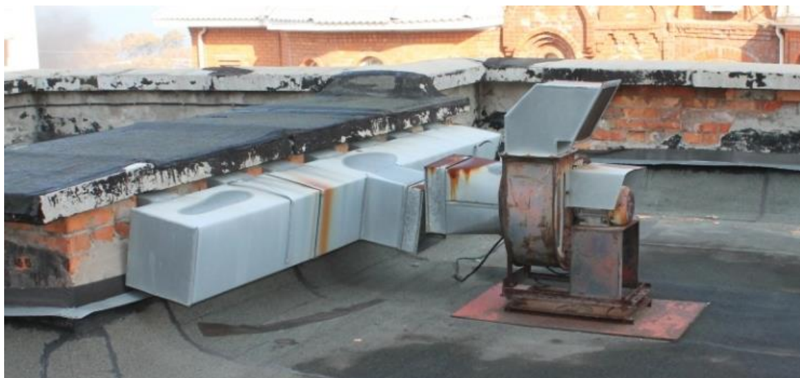
Рисунок 1.16 Вытяжной вентилятор спортзала
