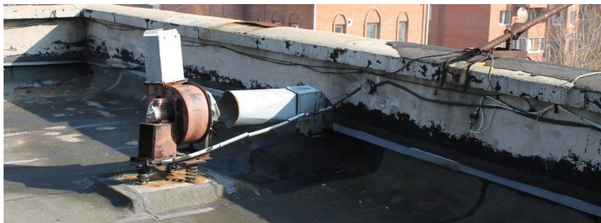
Рисунок 1.17 Вытяжной вентилятор спортзала
