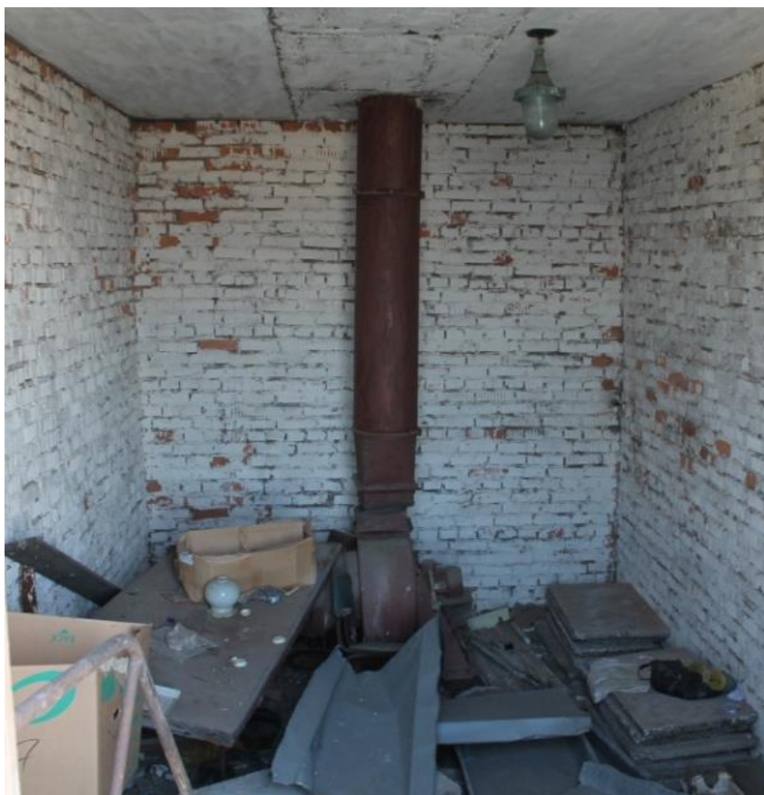
Рисунок 1.12 Вентиляционная камера вытяжной вентиляции
