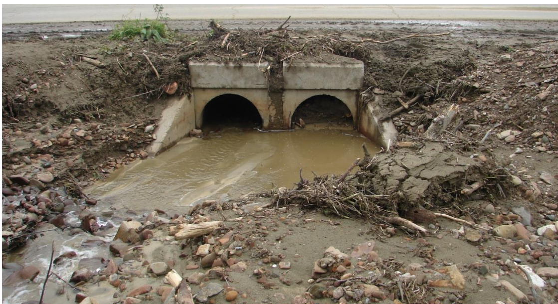
Рис. 3.11 Замытый селевыми отложениями водопропуск под полотном.
