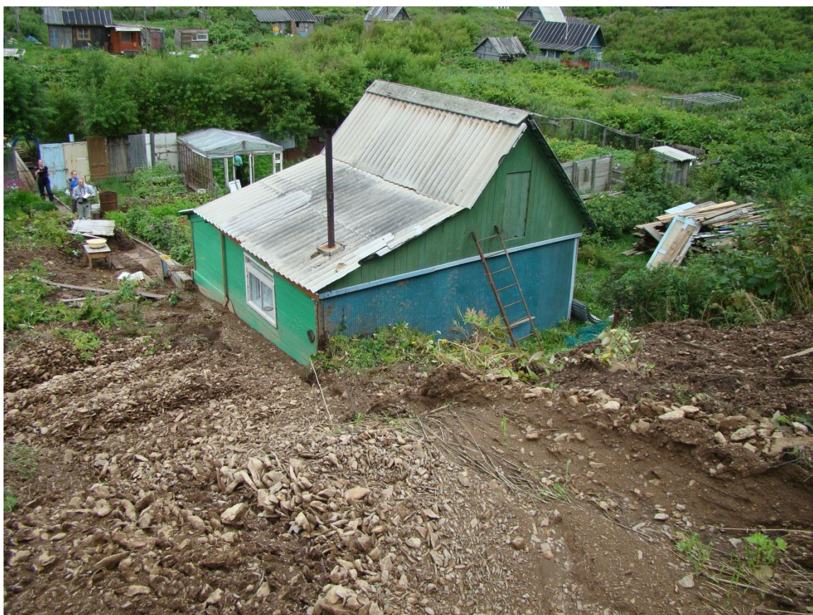
Рис. 3.5 Повреждение жилого дома от селевого потока г. Невельск. Фото Генсировского Ю.В.
