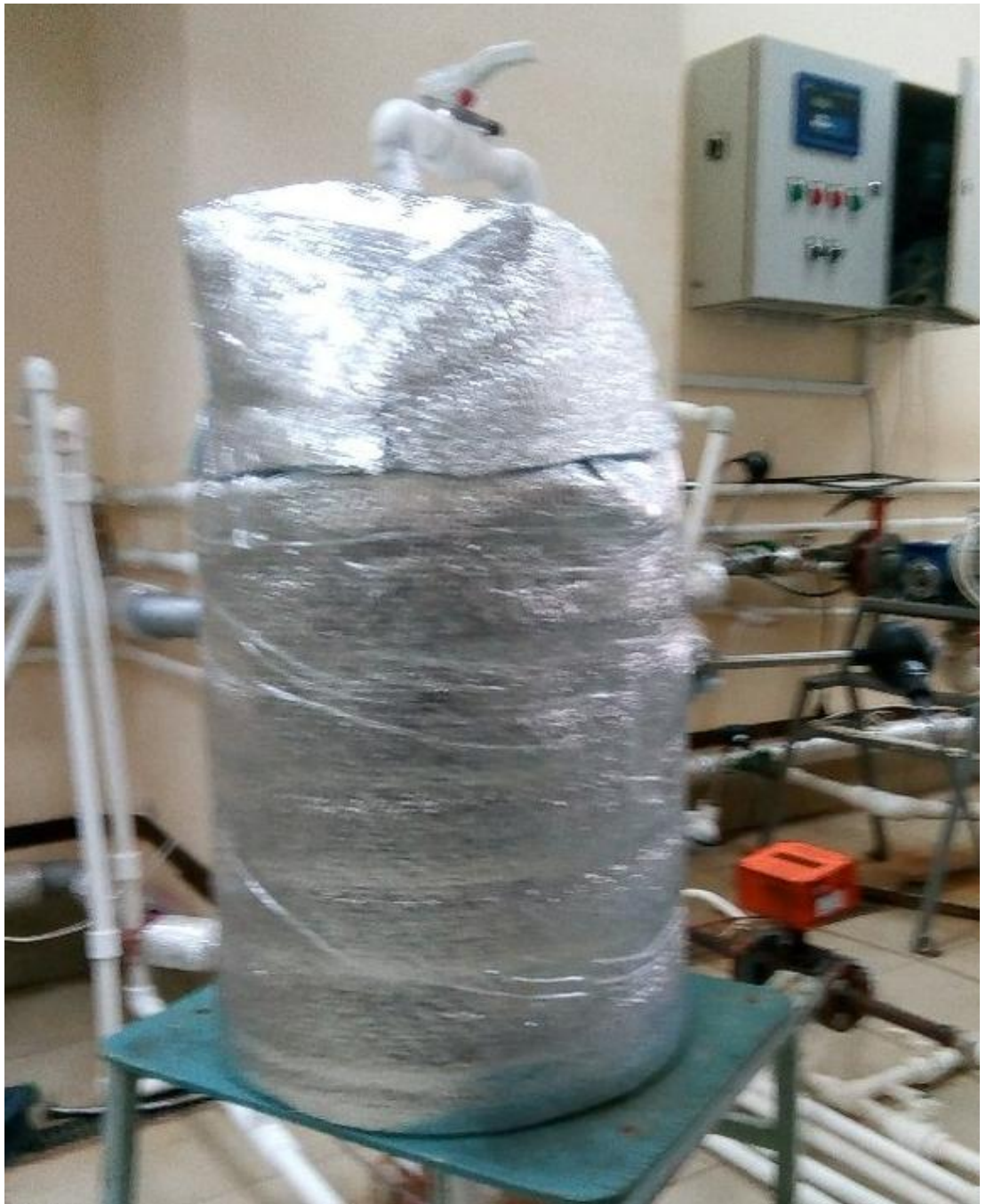
Рисунок 3.2 – Общий вид экспериментальной установки
