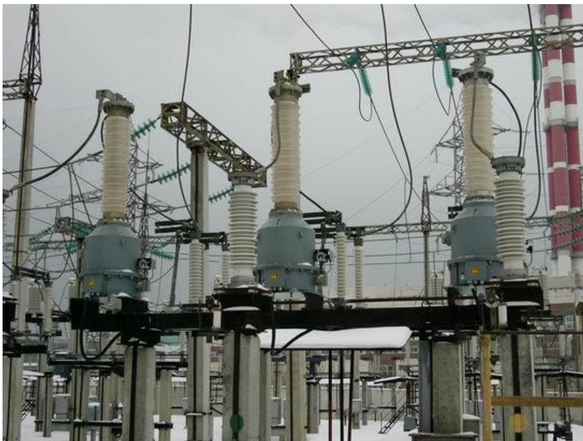
Рисунок 7.9 – Группа из 3 трансформаторов напряжения ЗНОГ-110
