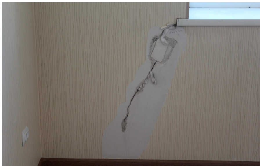
Рисунок 99 – Пример трещины, образовавшейся в зоне концентрации напряжений в угловых зонах оконных проемов
