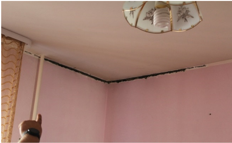
Рисунок 95 – Пример трещины, образовавшейся между плитами перекрытия и вертикальным стеновым заполнением
