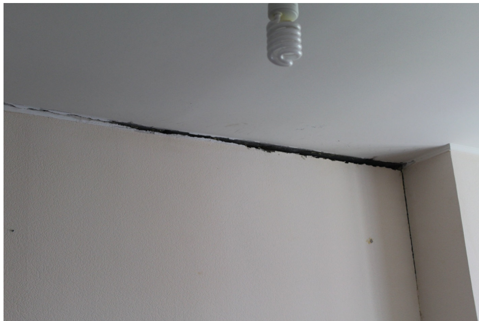
Рисунок 96 – Пример трещины, образовавшейся между плитами перекрытия и вертикальным стеновым заполнением
