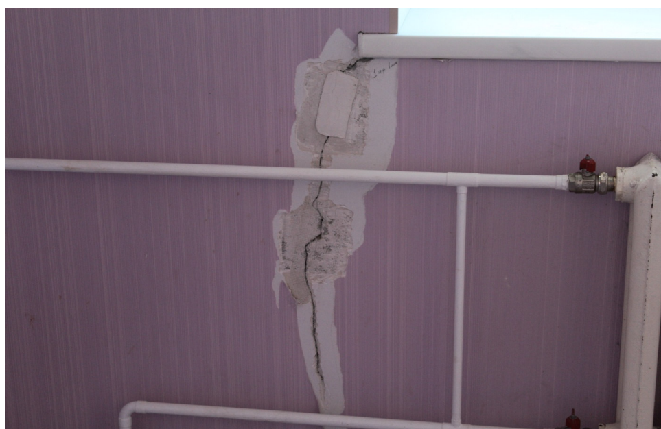
Рисунок 100 – Пример трещины, образовавшейся в зоне концентрации напряжений в угловых зонах оконных проемов
