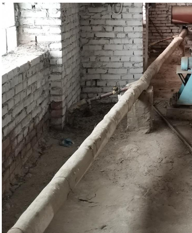
Рисунок 1.1 – Подающая магистраль и стояки отопления
