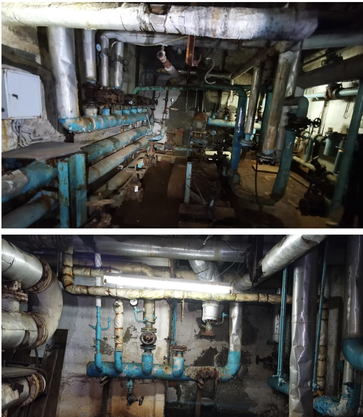
Рисунок 1.5 – Общий вид ИТП
