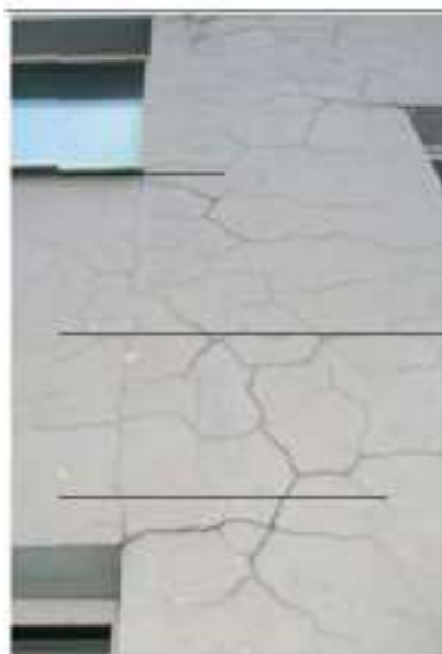
Рисунок 1.5 – Трещины на штукатурке, затворенной избытком воды [37]
