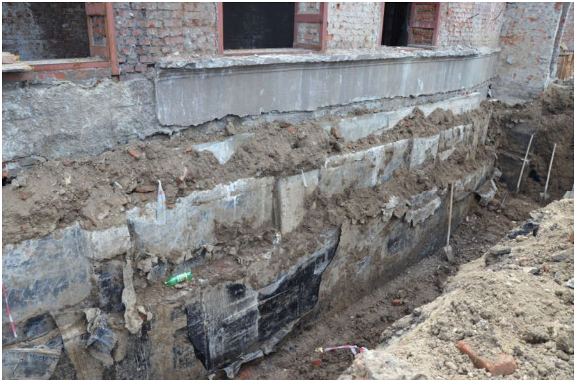
Рисунок 35 – Фундамент Ф 12 в осях Р-Ф/1-2. Отслоение гидроизоляции
