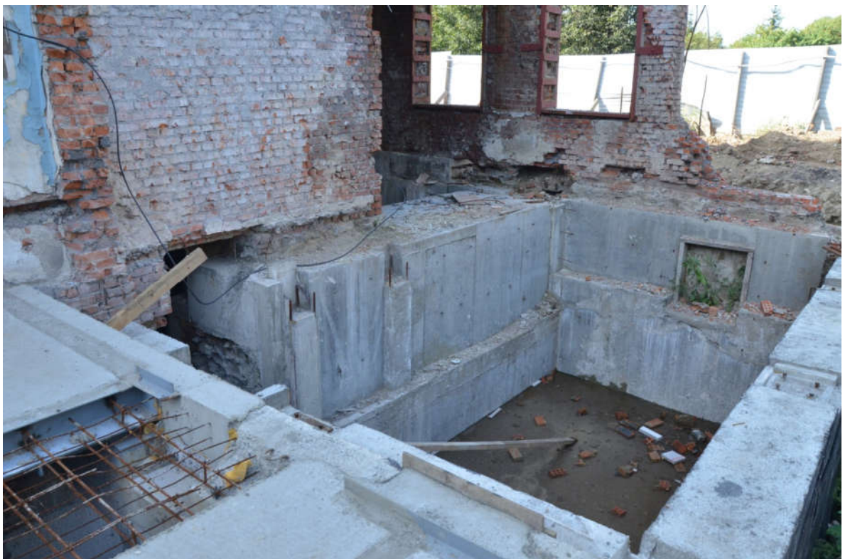
Рисунок 54 – Переделанный фундамент пристроенного помещения Ф15.1 в осях У/2-5
