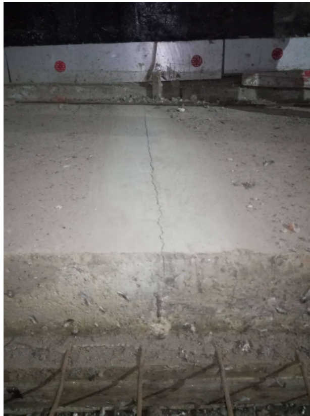
Рисунок 29– Горизонтальная трещина в монолитном фундаменте по оси 11 в осях С-Т
