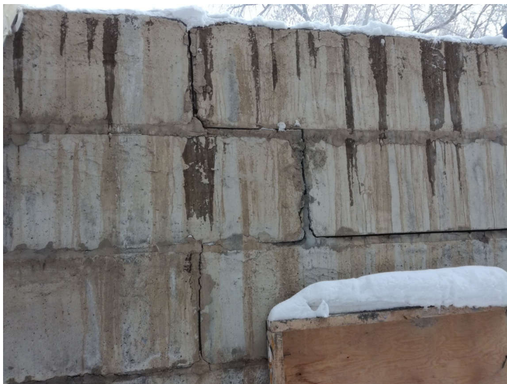
Рисунок 13 – Деформационные трещины в кладке бетонных блоков стены пристроенного технического помещения раскрытием более 0,5 мм
