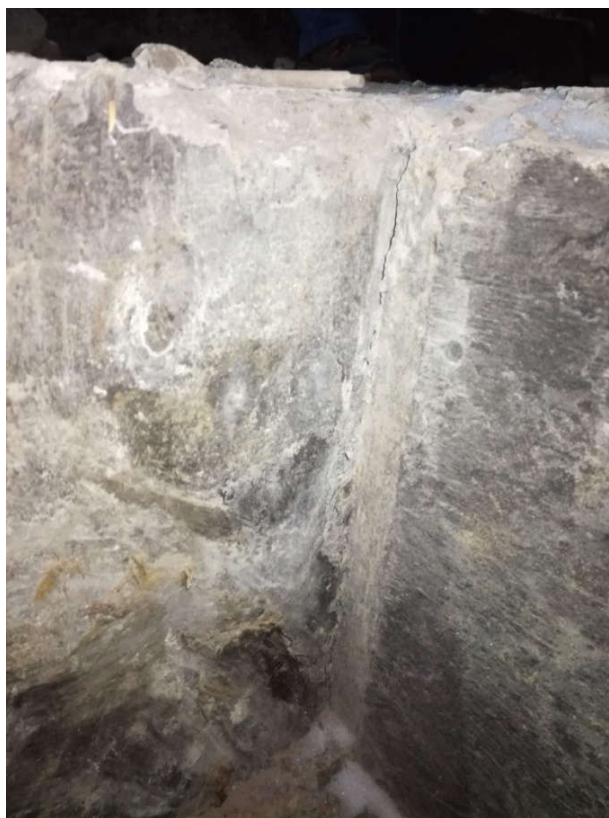
Рисунок 27– Вертикальная трещина в монолитном фундаменте по оси Г в осях 6-13
