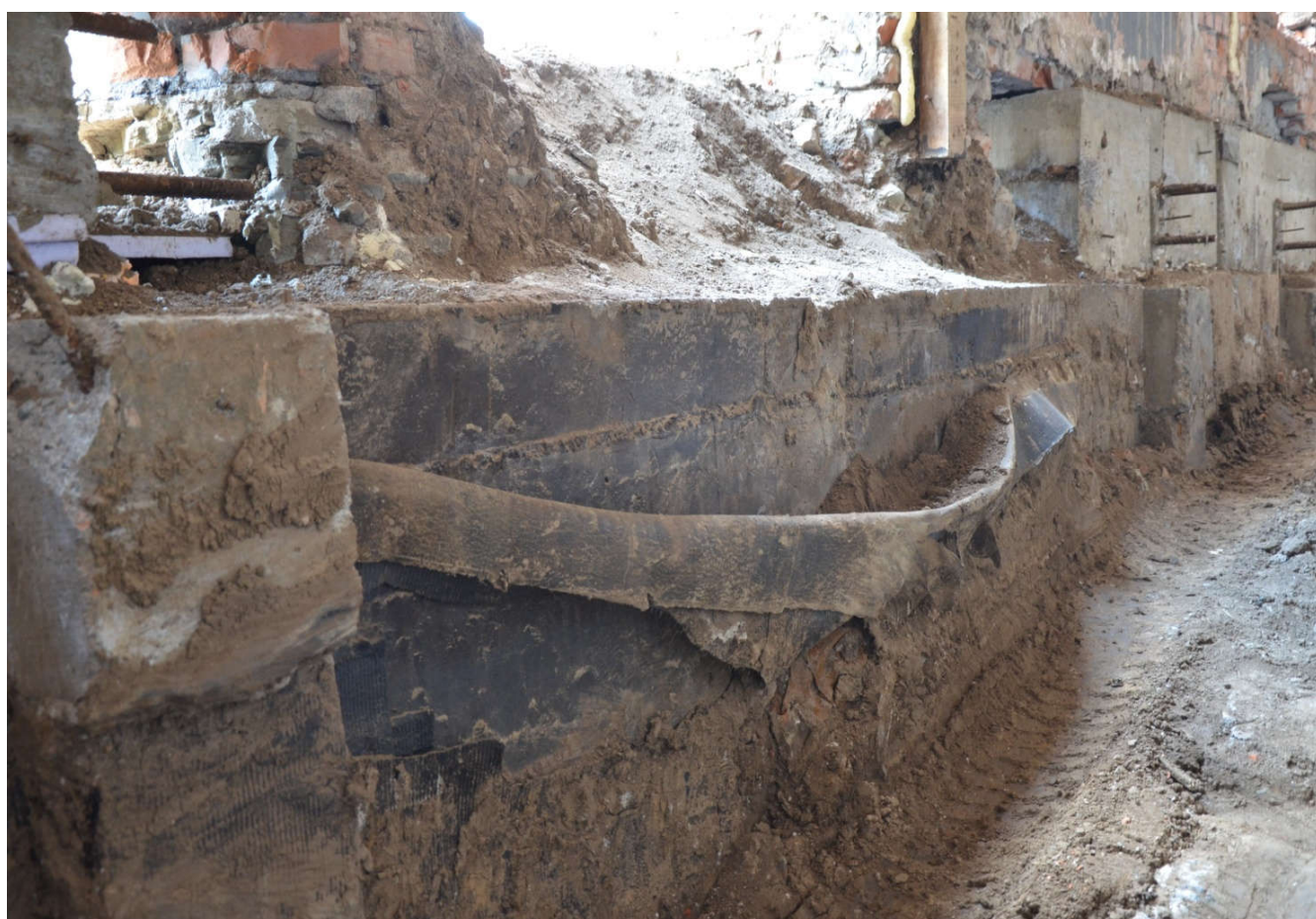
Рисунок 46 – Фундамент Ф9 в осях Э-И/14-16. Отслоение гидроизоляции
