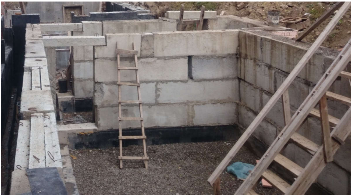
Рисунок 17 – Несоответствие раскладки блоков с рабочей документацией и частичное отсутствие заделки вертикальных швов между блоками ФБС в осях 7/Ф-Ю
