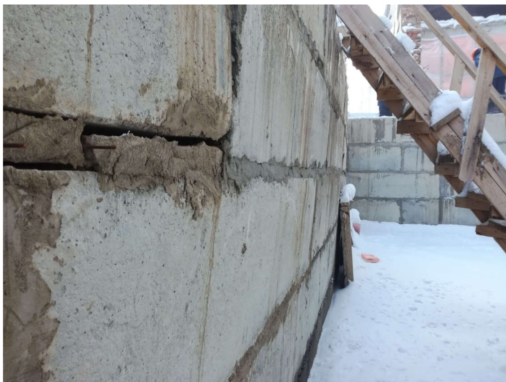
Рисунок 14 – Отклонение стены пристроенного технического помещения от вертикали до 50 мм
