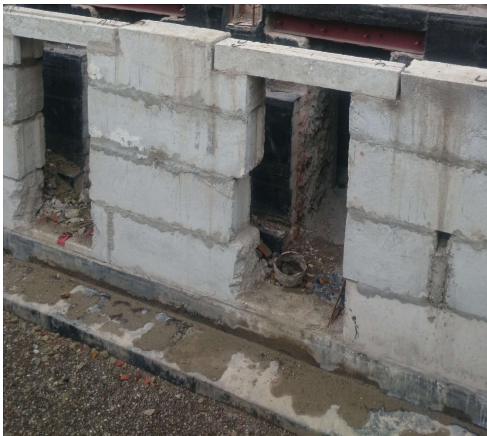
Рисунок 21 – Несоответствие раскладки блоков с рабочей документацией и частичное отсутствие заделки вертикальных швов между блоками ФБС по оси Ф
