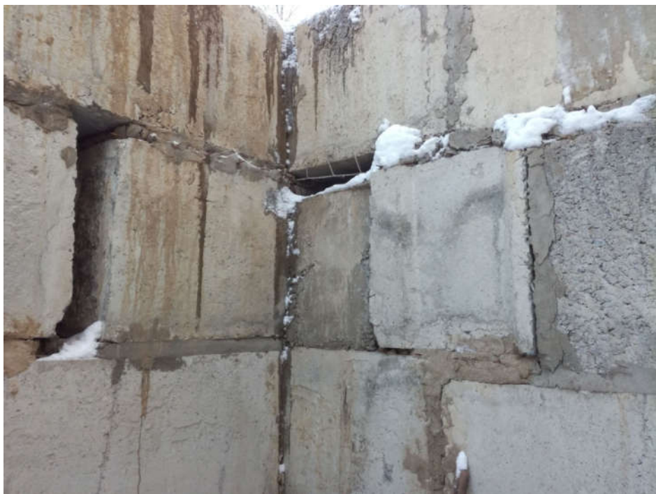
Рисунок 12 – Отсутствует замоноличивание участка в стене пристроенного технического помещения
