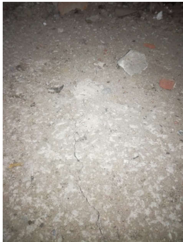
Рисунок 28 – Горизонтальная трещина в монолитном фундаменте по оси 8 в осях С-Т
