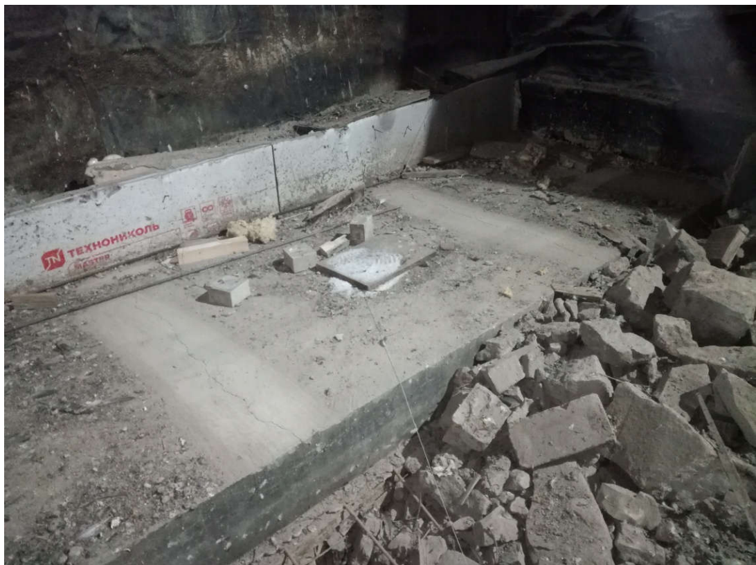
Рисунок 30 –Горизонтальные трещины в монолитном фундаменте по осям 12-13 в осях С-Т
