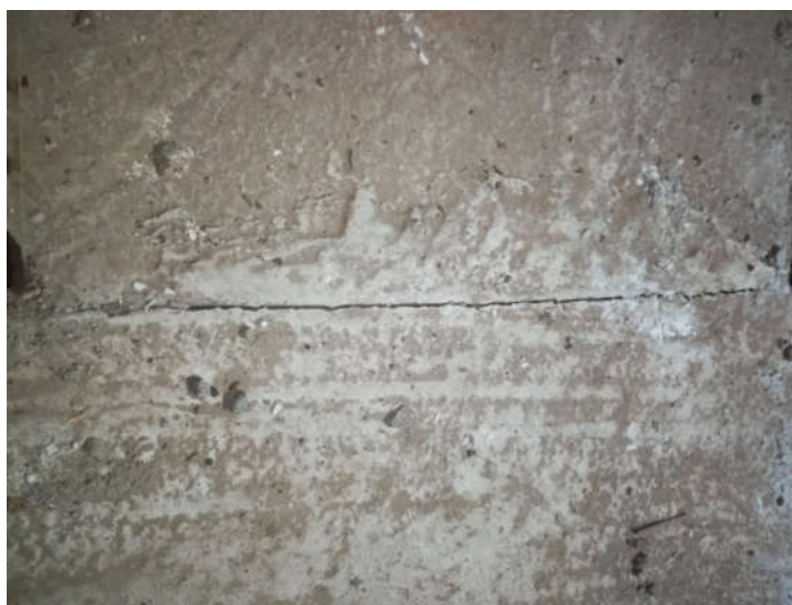
Рисунок 26 – Горизонтальная трещина в монолитном фундаменте по оси 6 в осях С-Т
