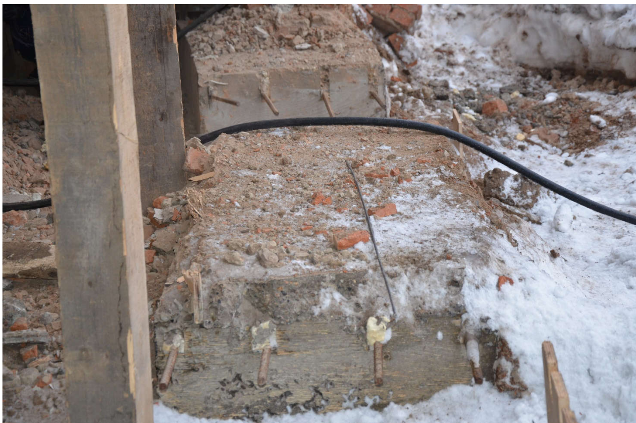
Рисунок 39 – Фундамент Ф 14 в осях Ж-Л/1-2. Армирование обвязочной балки выполнено из арматурных стержней Ø22 и Ø16, что отличается от принятой в рабочей документации (Ø18)
