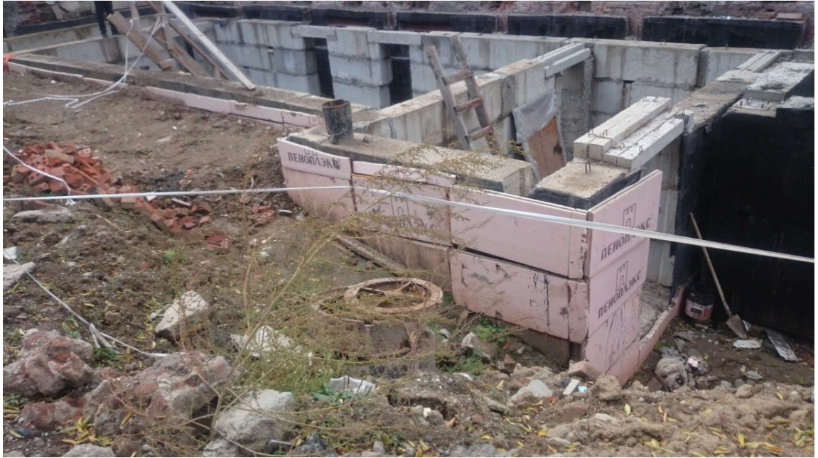
Рисунок 16 – Не закрепленные плиты утеплителя в осях 6-7/Ю
