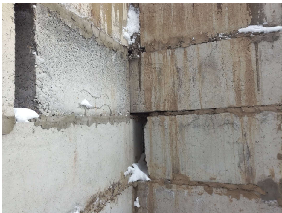
Рисунок 10 – Отсутствует замоноличивание участков в стене пристроенного технического помещения
