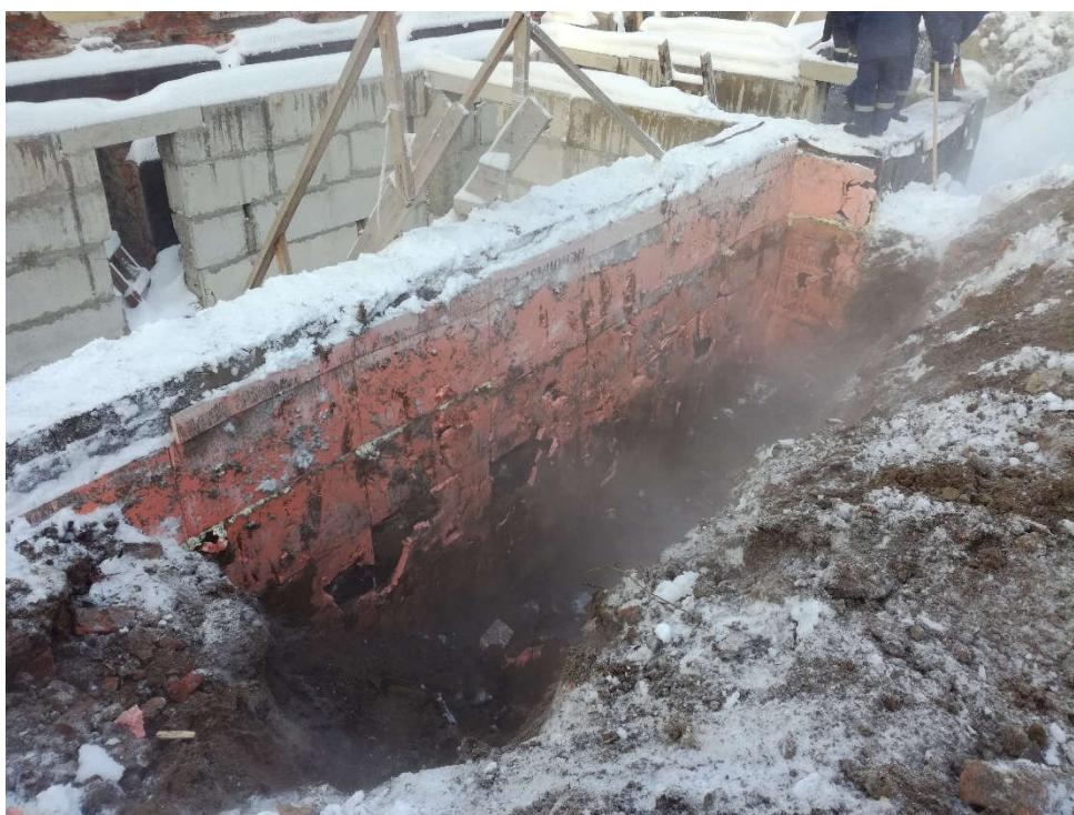
Рисунок 8 – Стена технического, пристроенного помещения из бетонных блоков ФБС на монолитном ростверке на естественном основании
