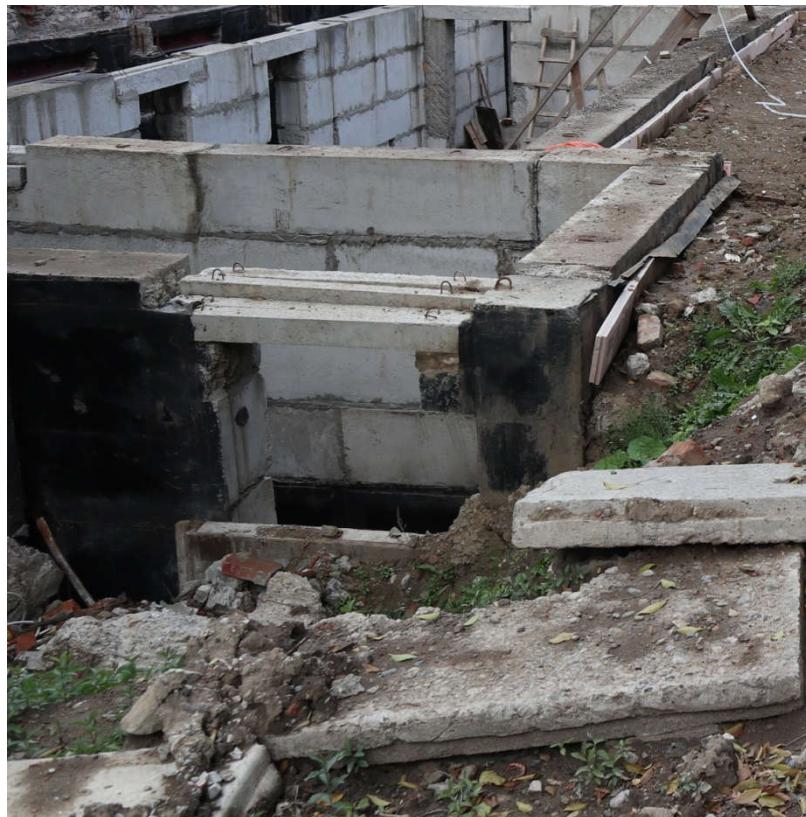
Рисунок 24 – Утеплитель не смонтирован в осях Ю/12
