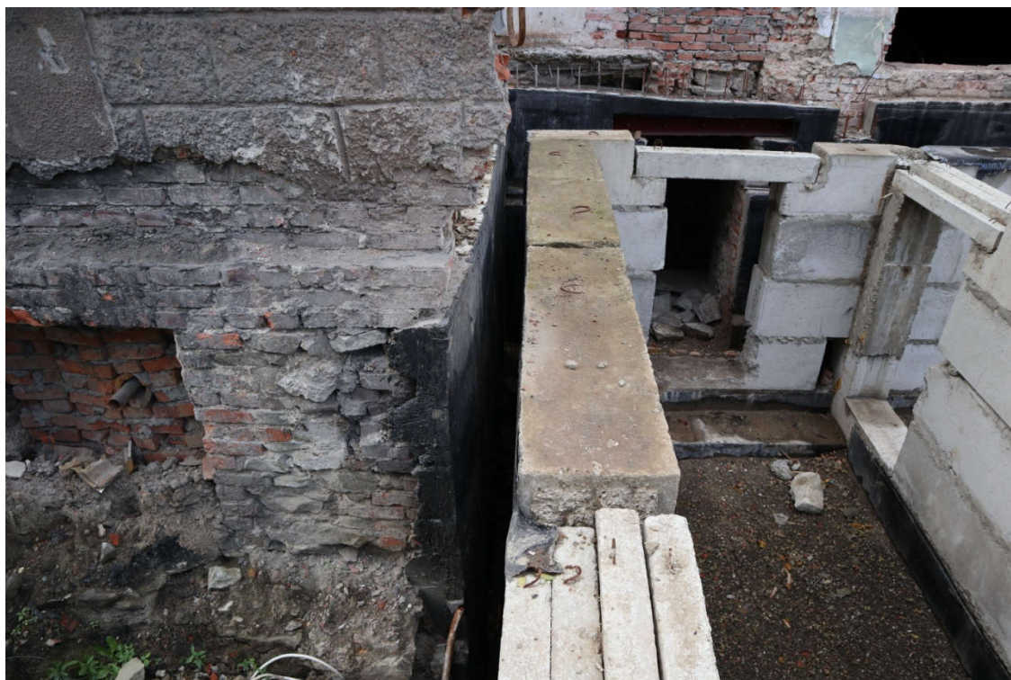
Рисунок 25 – Гидроизоляция выполнена не в полном объёме по оси 12
