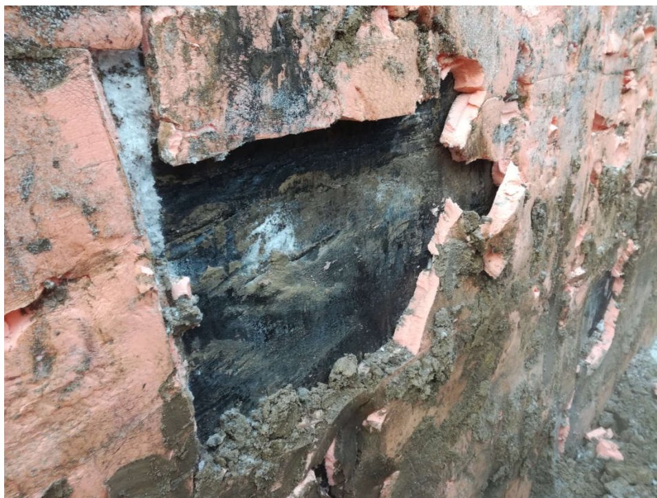
Рисунок 9 – Вскрытие утеплителя в стене пристроенного технического помещения
