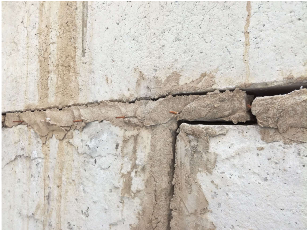
Рисунок 11 – Деформационные трещины в кладке бетонных блоков стены пристроенного технического помещения раскрытием более 0,5 мм
