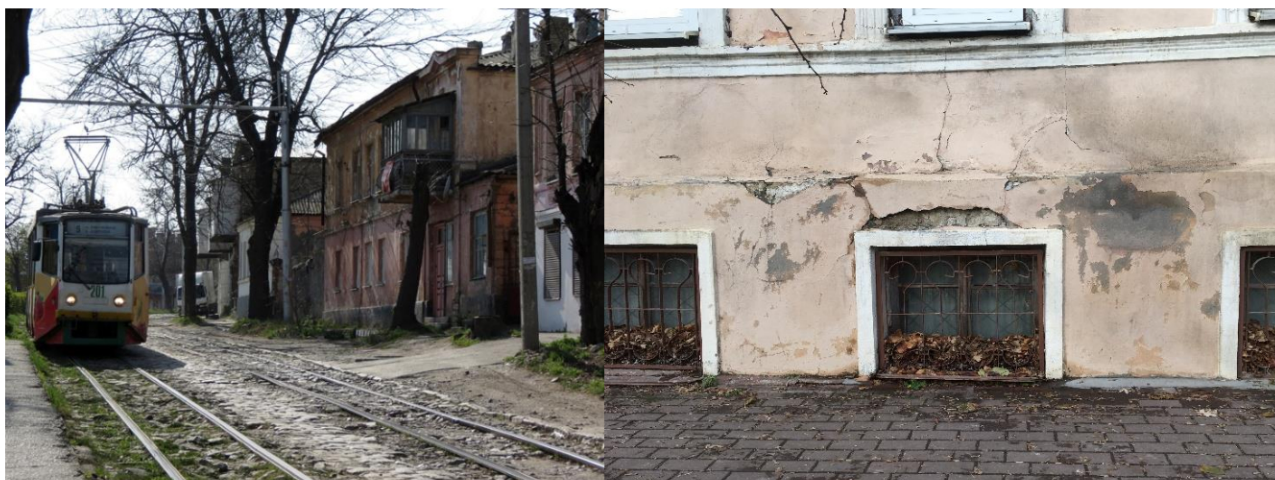
Рисунок 2.8 - Влияние транспорта на здание исторической застройки (декабрь 2017 г.)
