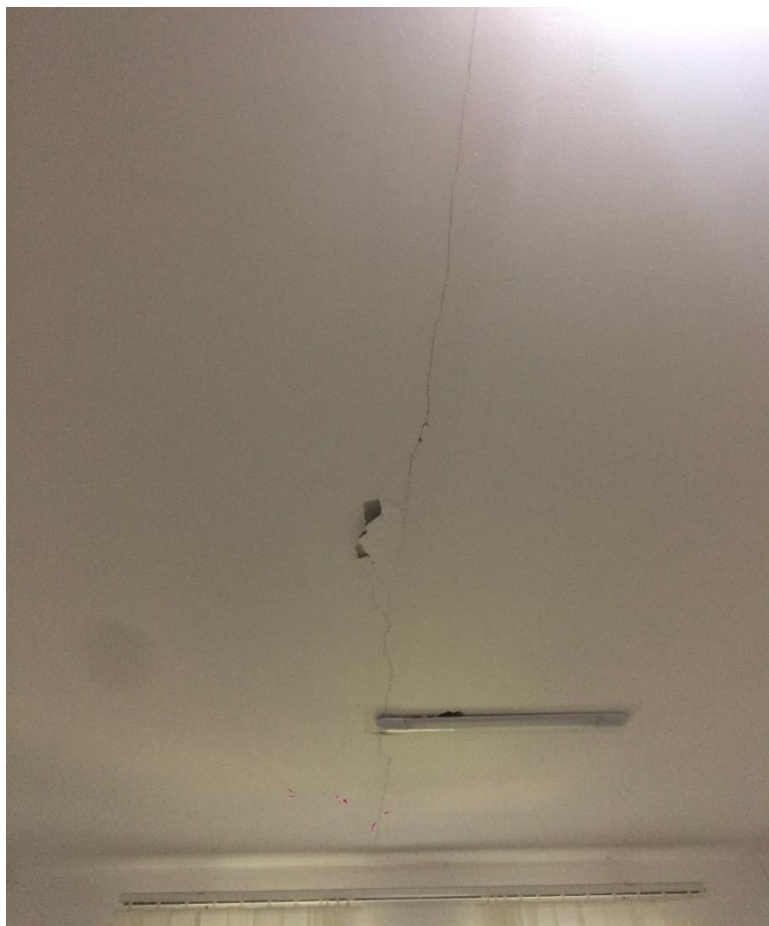
Рисунок 63 Образование трещины в перекрытии здания администрации МО "Ахтынский район".
