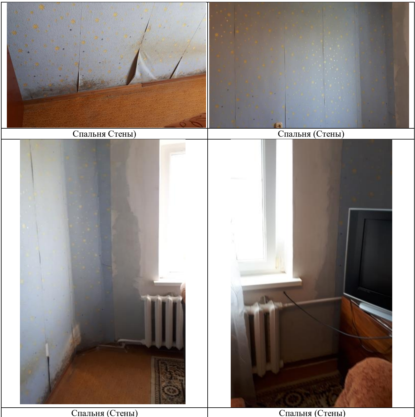
Рисунок 3.12 –Спальная квартиры, подвергшейся заливу
