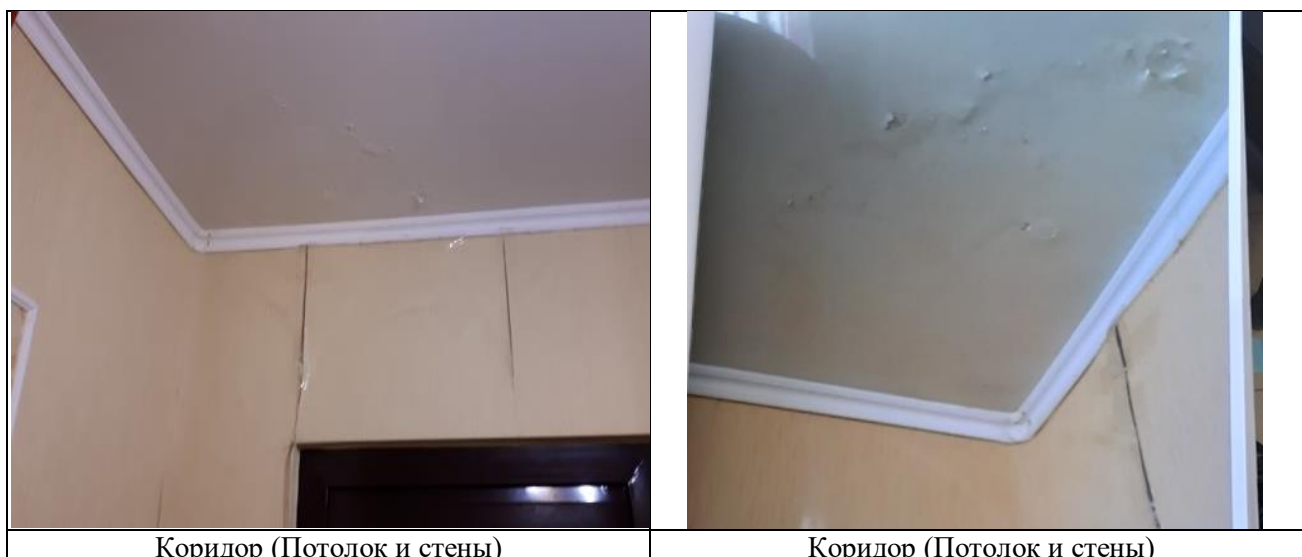
Рисунок 3.14 – Коридор квартиры, подвергшейся заливу
