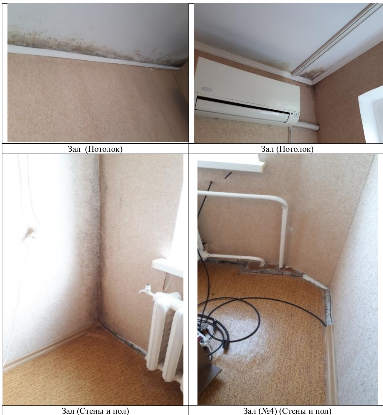
Рисунок 3.10 –Зал квартиры, подвергшейся заливу
