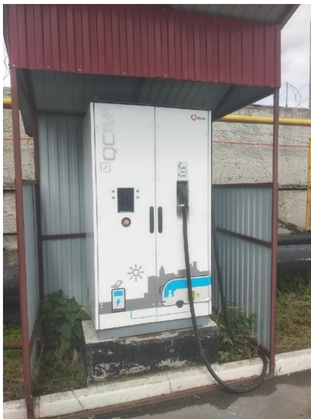
Рисунок 3.2 Станция для подзарядки электробуса
