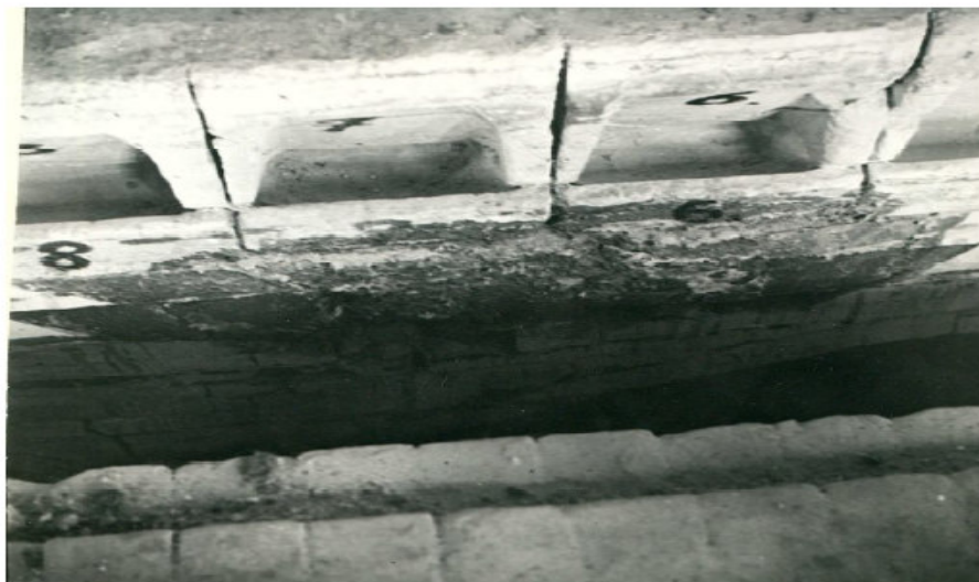
Рисунок 4.18 – Черное пятно на разделительной стенке электролизера в зоне 5 – 8 переточных камней. Вид со стороны сборной ячейки
