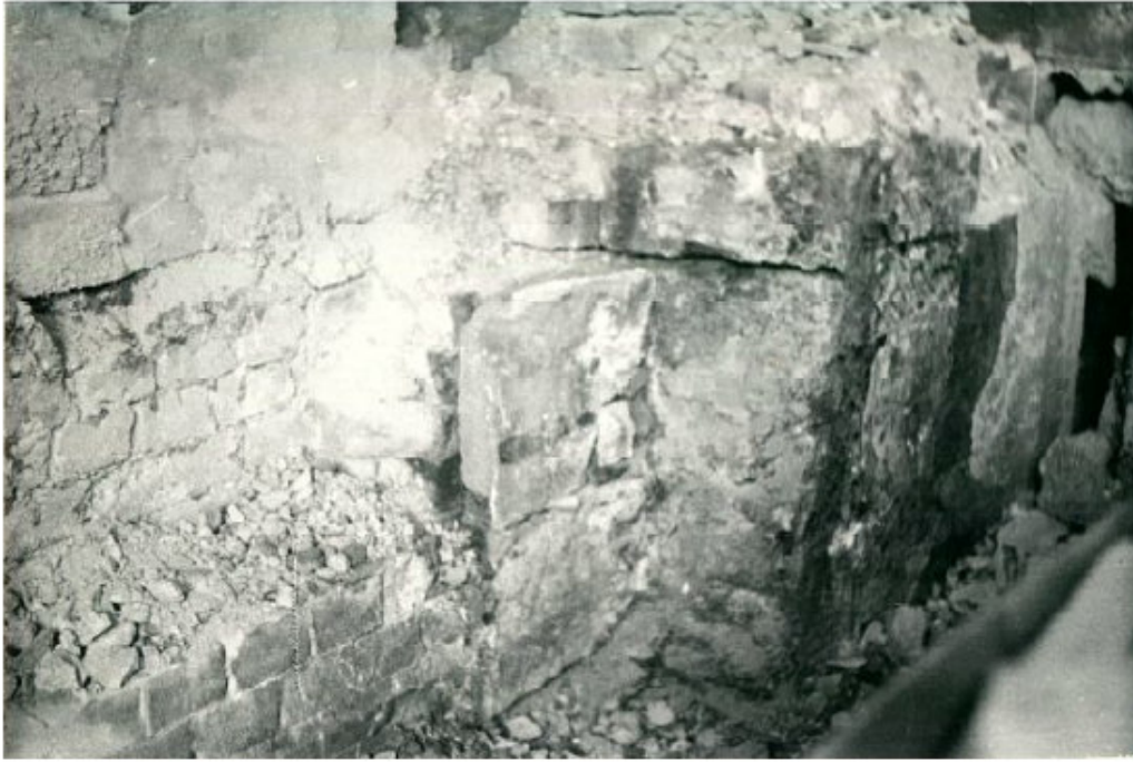
Рисунок 4.21 – Часть элемента угловой защиты, сохранившаяся на торцевой стене электролизера после 30 месяцев эксплуатации
