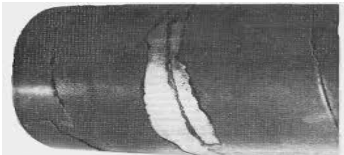
Рисунок 2 – Продукты коррозии на поверхности трубы в виде спиральной полосы, в месте нахлестав полимерной ленты
