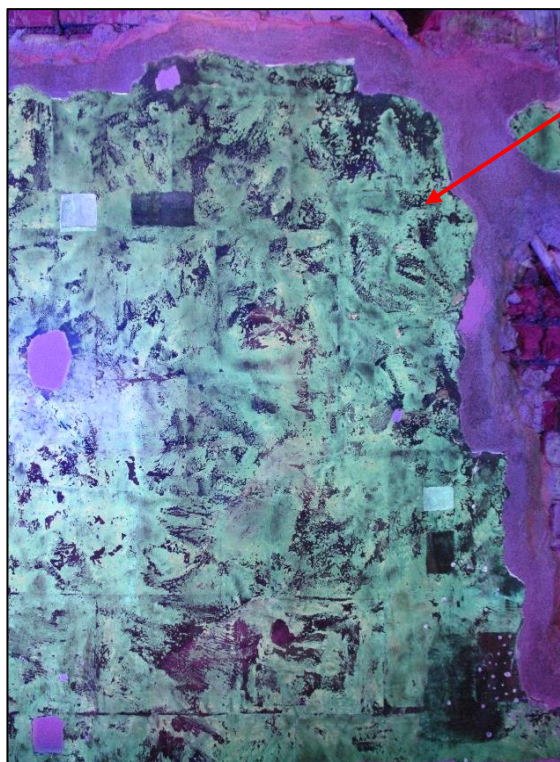
Общий вид реставрируемого участка до удаления слоя воско-смоляной мастики. В свете видимой УФ-люминесценции.
