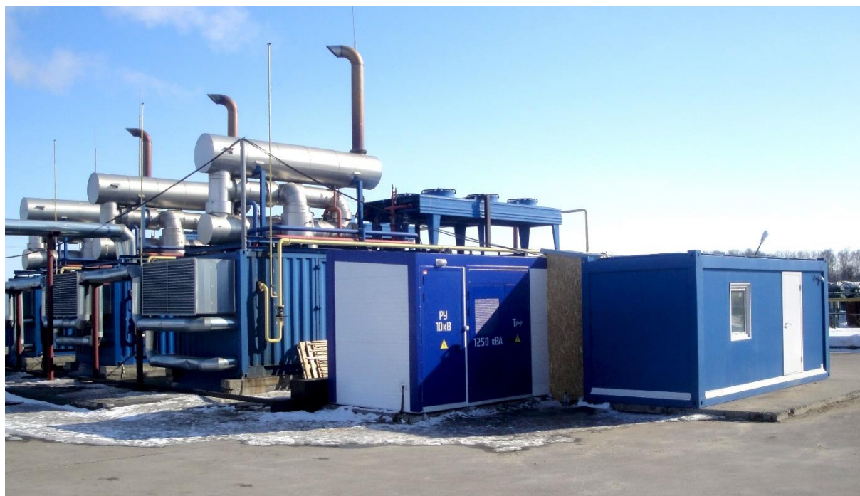
Рисунок 3.1 – Экспериментальная установка для испытаний совместной работы СНЭ-10-1200-400 и ГПУ
